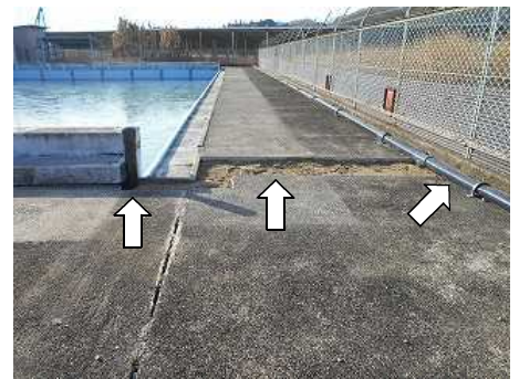
プールサイドに設置された送水管
